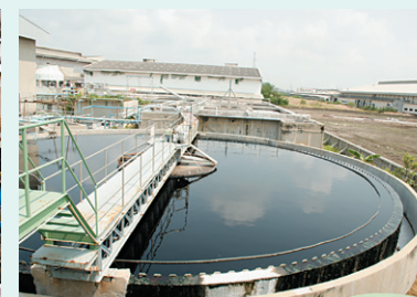
排水処理システム
