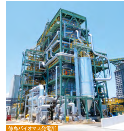
徳島バイオマス発電所
