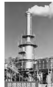
排煙脱硫装置
