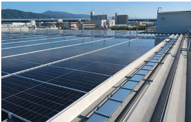
寝屋川工場の太陽光パネル 導入事例
